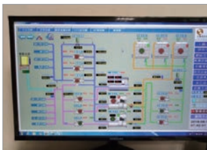
▲ 設置空調環控系統
